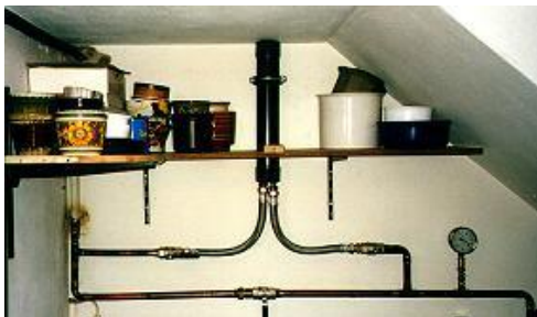
Instalación en la parte de atrás del contador de agua
