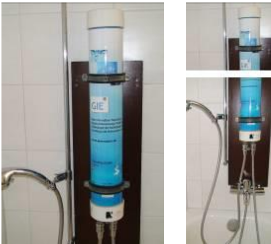
Una simple instalación en la ducha o en el baño
