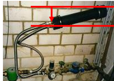
Montaje colocado en forma inclinada, pero la conexión siempre queda hacia abajo
